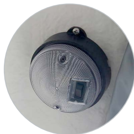
Innenbeleuchtung (nicht blendend)
